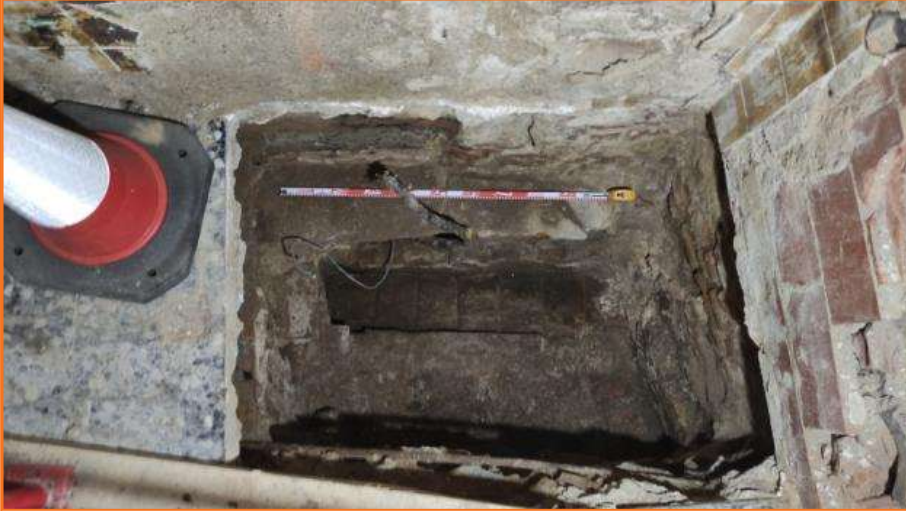
Foto 25. Vista de la claveguera UE 27 i de la fonamentació de la UE 23.
